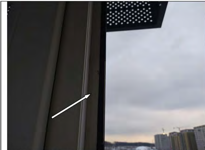
Фото №28. Дефект установки части уплотняющей прокладки на оконном блоке ПВХ в кухне.
