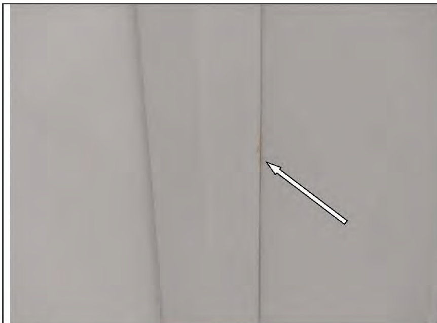
Фото №46. Коробка входной металлической двери имеет дефекты (загрязнение малярными составами).
