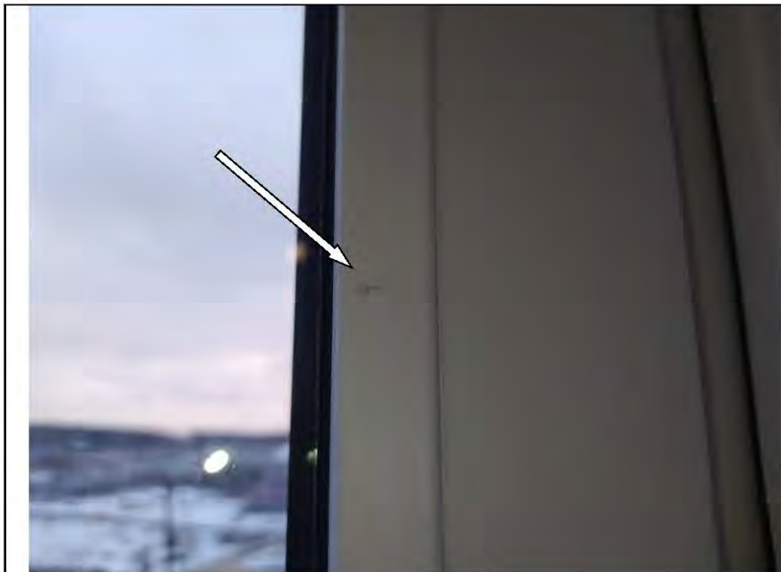
Фото №22. Профиль ПВХ оконного блока в спальне имеет дефекты (царапины).
