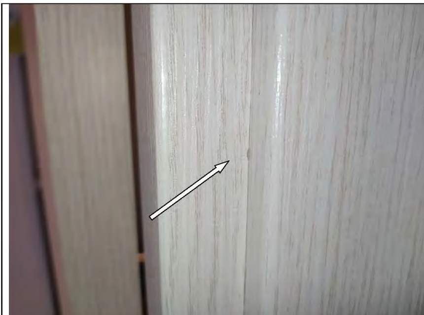
Фото №34. Коробка деревянного дверного блока в ванной комнате имеет дефекты (скол).
