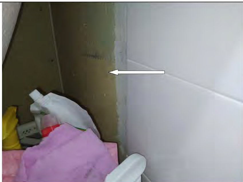
Фото №47. Частично отсутствует настенная керамическая плитка за ванной.
