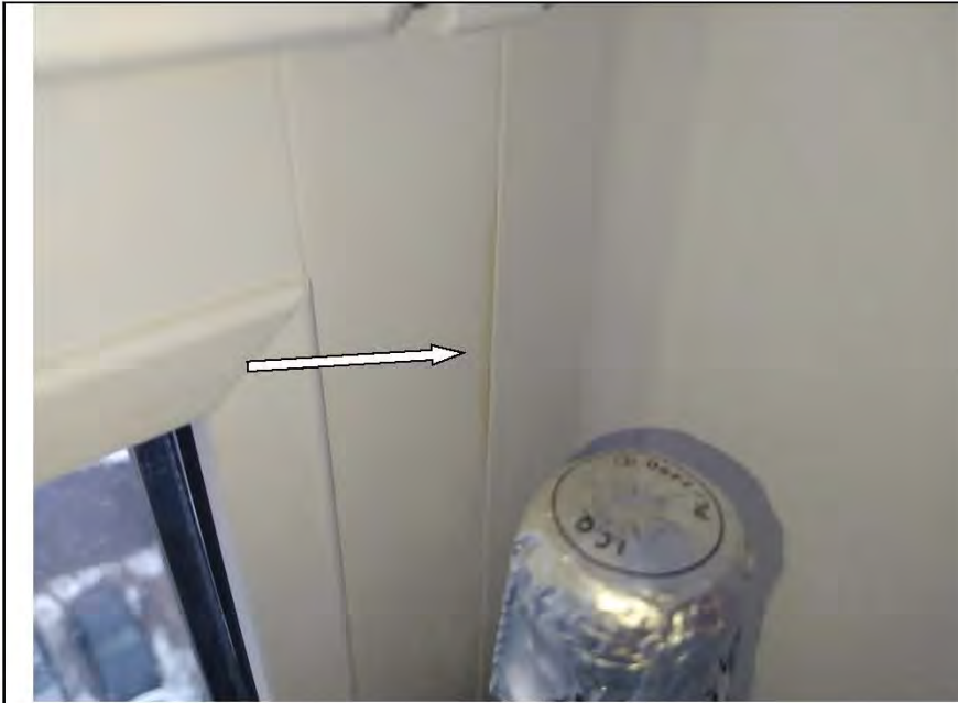
Фото №19. Профиль ПВХ оконного блока в кухне имеет дефекты (загрязнение строительными составами).
