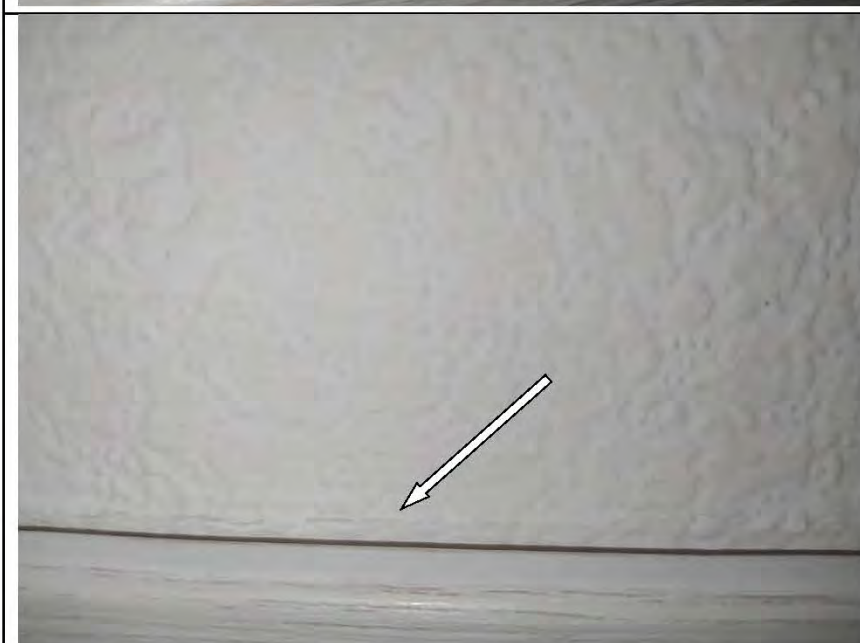
Фото №36. Неплотное прилегание дверного наличника к стене в ванной комнате.
