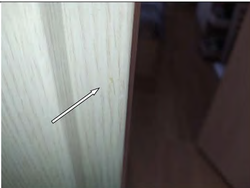
Фото №33. Коробка деревянного дверного блока в спальне имеет дефекты (скол).
