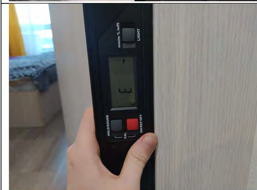
Фото №30. Отклонение коробки дверного блока в спальне.
