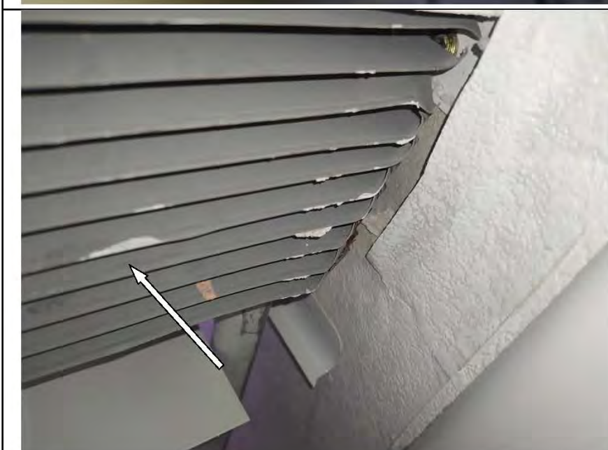
Фото №27. Радиатор в спальне имеет дефекты (загрязнение малярными составами).
