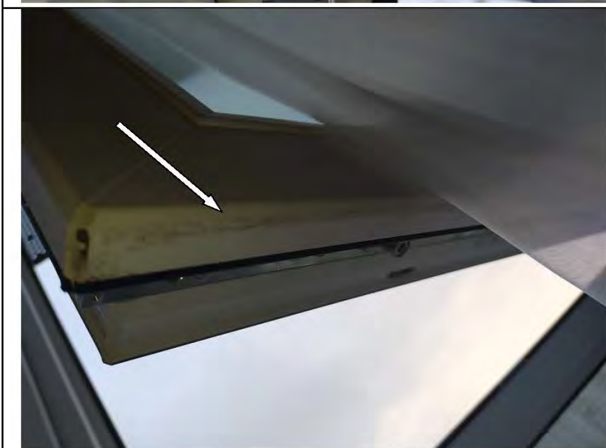
Фото №21. Профиль ПВХ оконного блока в спальне имеет дефекты (царапины).
