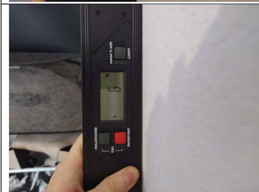
Фото №6. Измерения уровня стен в спальне.
