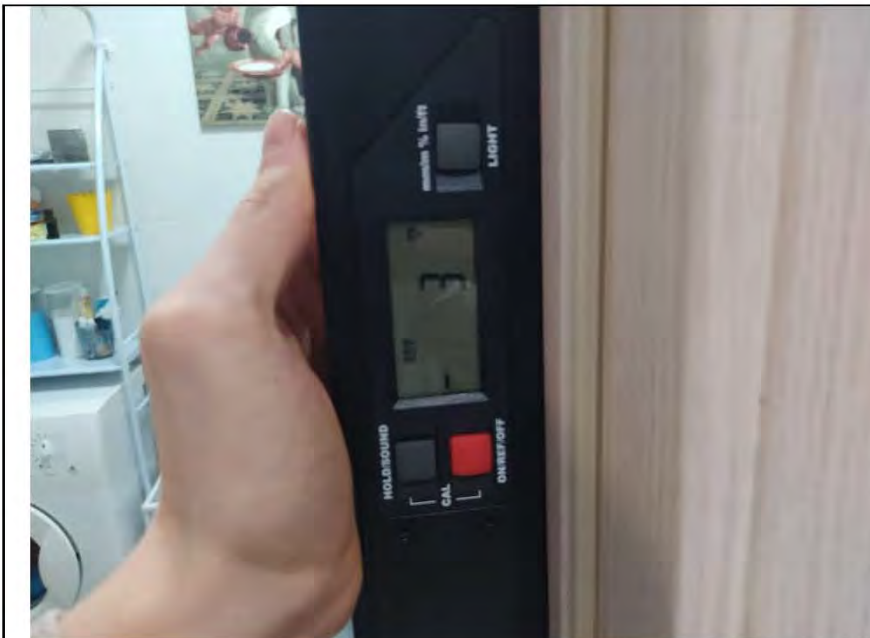
Фото №31. Отклонение коробки дверного блока в ванной комнате.
