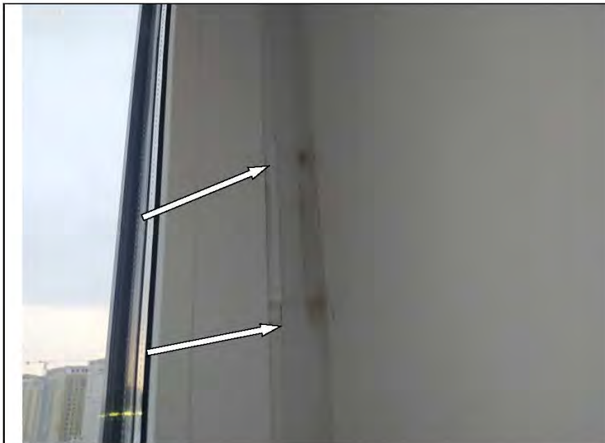
Фото №16. Следы скопления пыли, свидетельствующие об инfiltrации воздуха через петли оконного блока в кухне.
