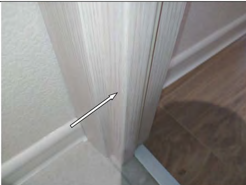
Фото №32. Коробка деревянного дверного блока в спальне имеет дефекты (загрязнение малярными составами).
