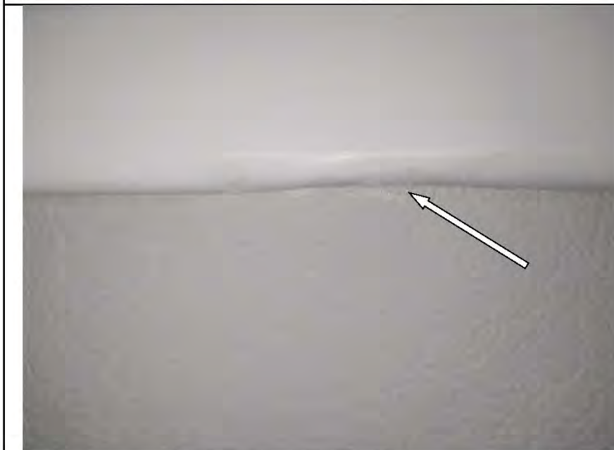
Фото №24. На лицевой поверхности подоконной доски в спальне имеются дефекты (замятия).
