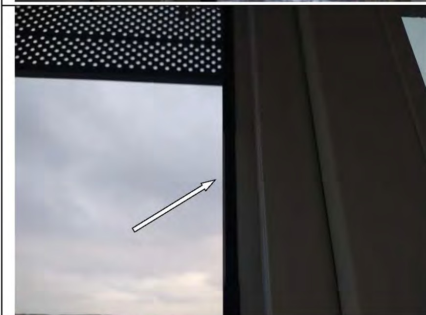
Фото №29. Дефект установки части уплотняющей прокладки на оконном блоке ПВХ в спальне.
