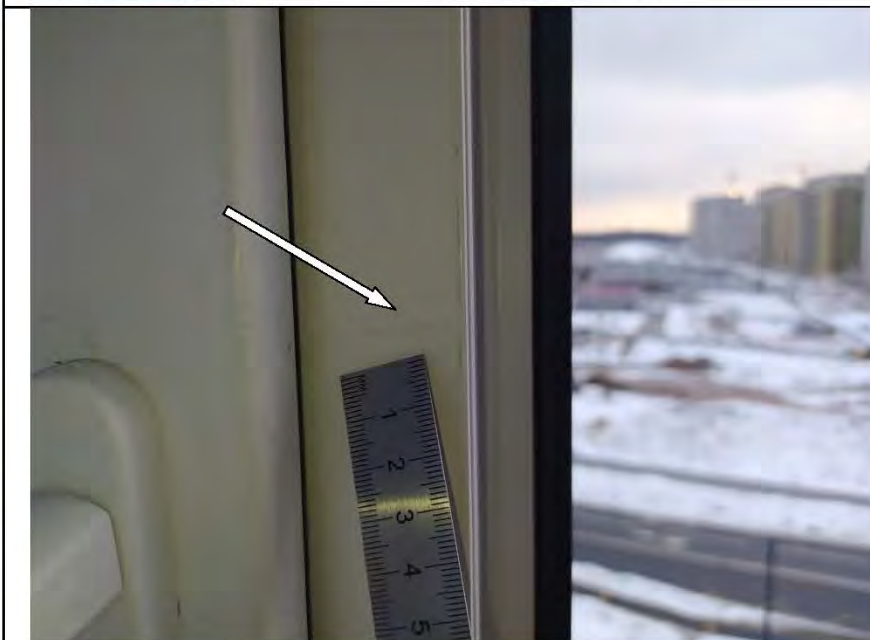
Фото №20. Профиль ПВХ оконного блока в кухне имеет дефекты (царапина).
