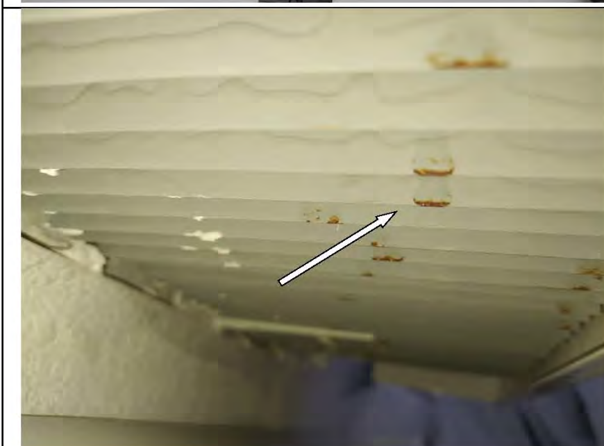
Фото №26. Радиатор в кухне имеет дефекты (коррозия).
